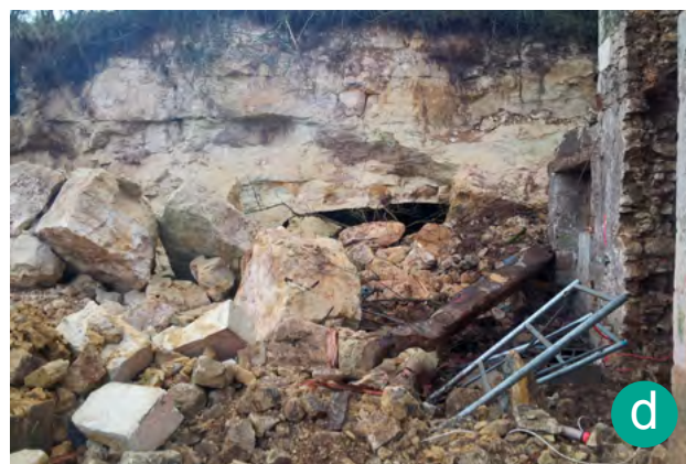
Figure 17 : illustration de la typologie des désordres : en a pierres et petits blocs, Mousseaux-sur-Seine (78) ; en b chute de blocs, Mousseaux-sur-Seine (78), en c éboulement de gros blocs, Auvers-sur-Oise (95) et en d effondrement de plusieurs dizaines de m 3 , Saint Epain (37) (Source : Cerema et Cavités 37)
