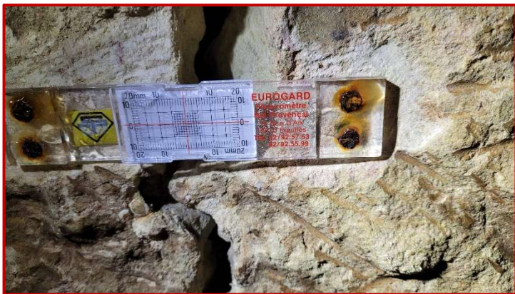
Présentation d'un témoin de fissure millimétré.
