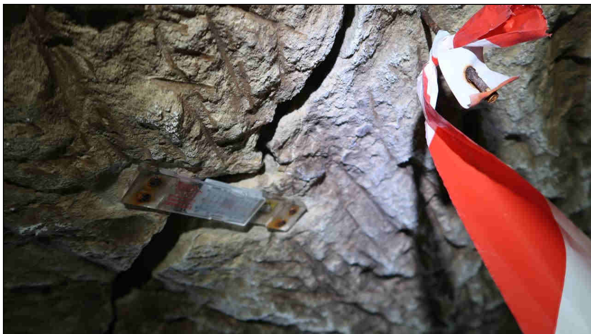
Des témoins de fissures sont installés un peu partout. Métivier)
