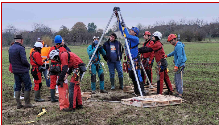
30 novembre 2023 – Mise en place d'une chèvre tripode pour descendre dans un effondrement survenu dans un champ de la Tour-Saint-Gelin-37-.
