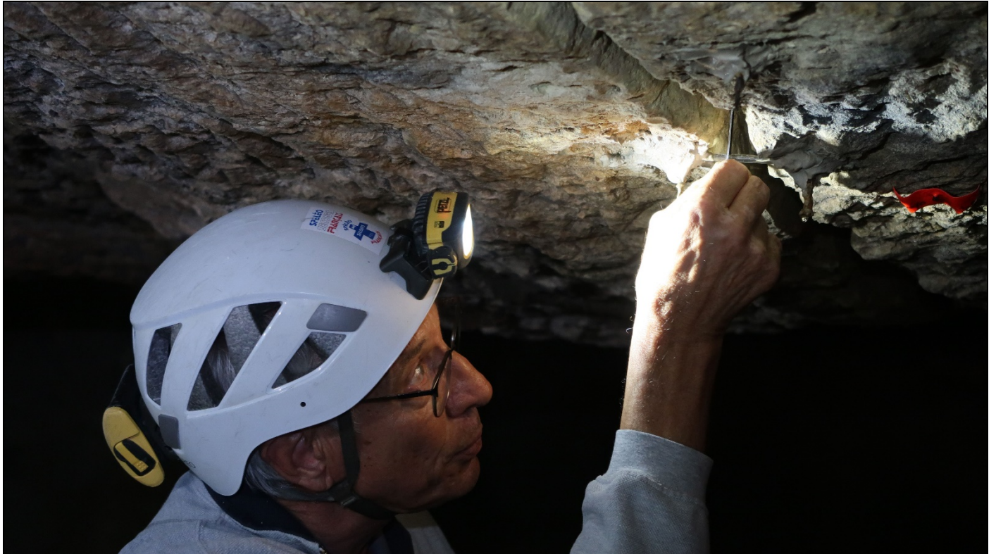
François Gay mesure l'écartement d'une fissure.
